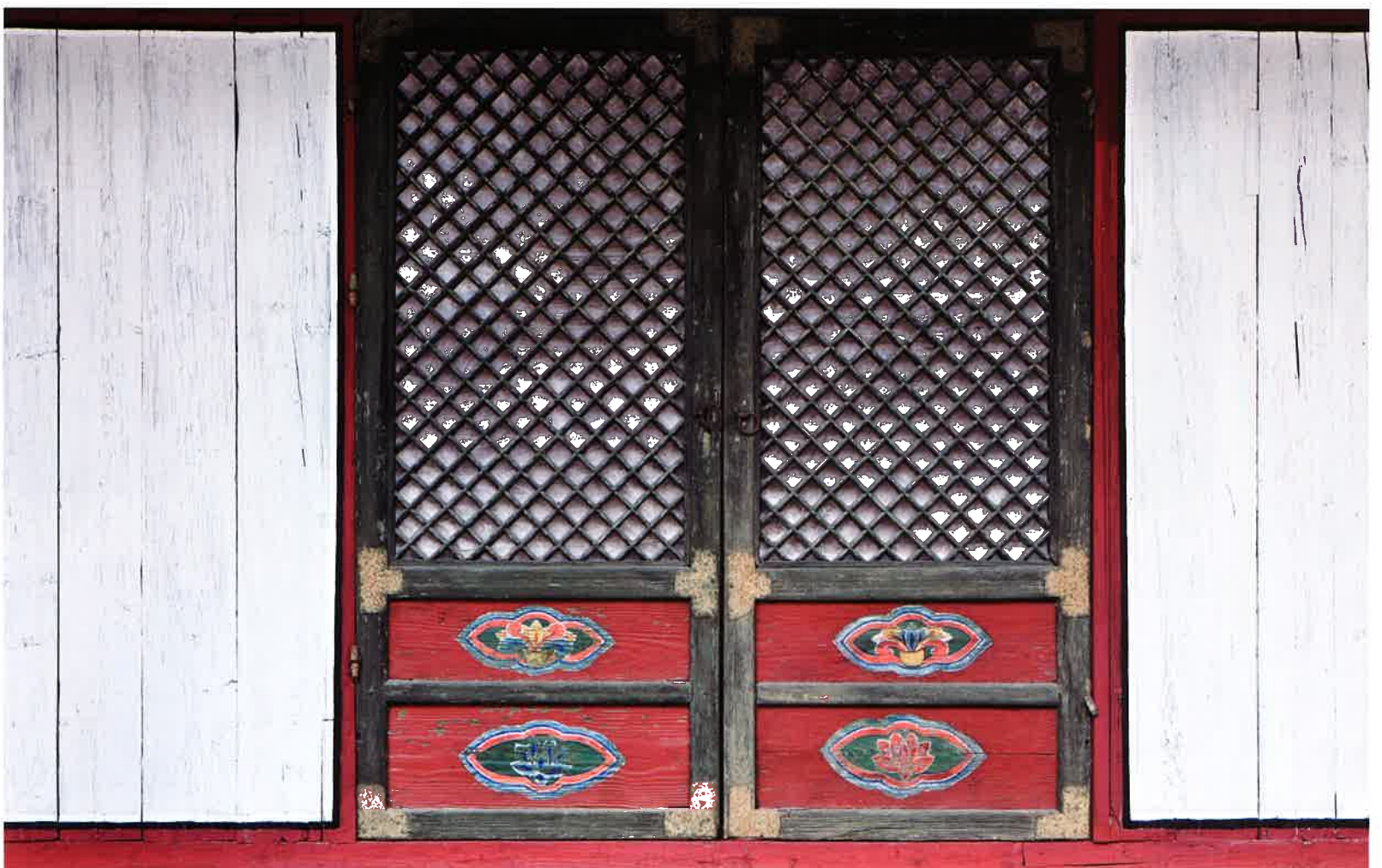
영산전 앞면 동쪽 협간 창호 / 靈山殿 前面 東側 夾間 窓戶 / front eastern doors, Yongsanjön hall
