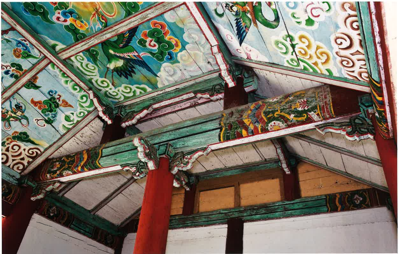
해탈문 내부 대들보와 반자 / 解脫門 內部 大樑·天障 / main beam and ceiling, Ha'almun gate
