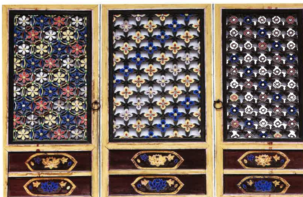
대웅전 앞면 동쪽 제2협간 창호 / 大雄殿 前面 第2夾間 窓戶 / doors, 2nd aspect of eastern side, Taegungjŏn hall
