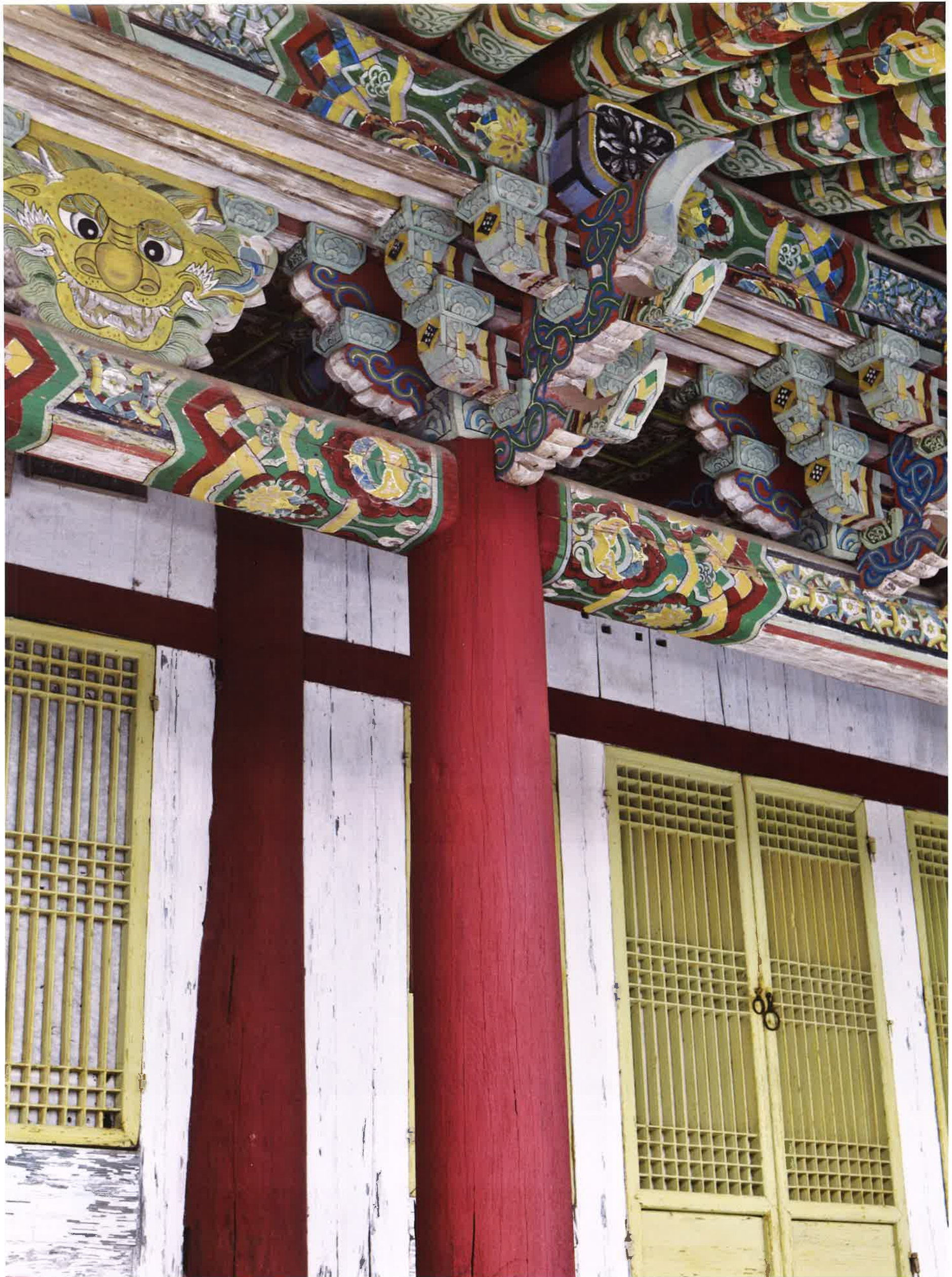
불영암 앞면 주상포 / 佛影庵 前面 柱上包 / brackets above front columns, Puryongam
