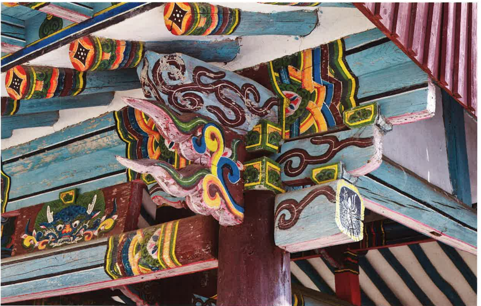
청풍루 뒷면 서쪽 귀포 / 淸風樓 後面 西側 耳包 / backward western corner brackets, Ch'ongp'ungnu
