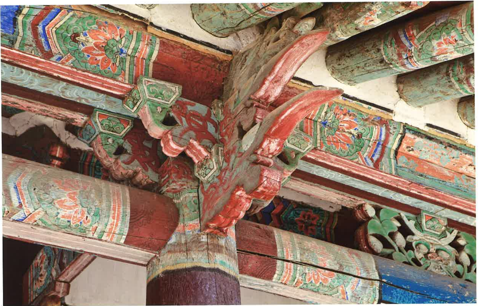
명부전 앞면 주상포 / 冥府殿 前面 柱上包 / brackets above front columns, Myongbujon hall
