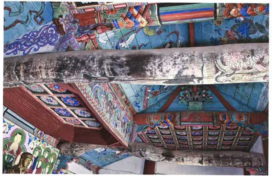
명부전 내부 대들보와 종보 / 冥府殿 內部 大樑·宗樑 main beam and collar beam, Myongbujon hall
